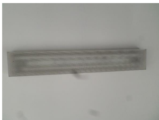
Figura 4.13 - Particolare dei corpi illuminanti installati a soffitto
