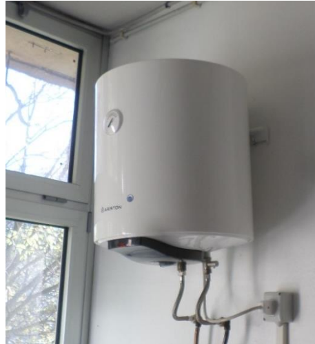
Figura 4.12 – Particolare di un boiler elettrico per la produzione di acqua calda sanitaria
